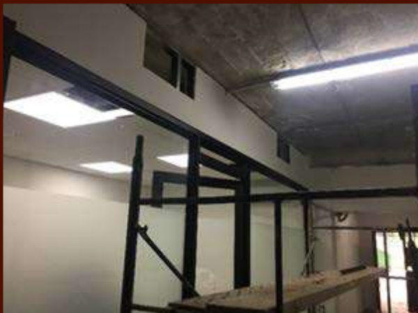
Ventilaciones en dintel para ventilación de cielo.
